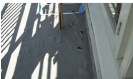
Een scheuroverbruggende coating 12 jaar geleden aangebracht, na 4 jaar hersteld met een nieuwe coating. In 2003 opnieuw een volledig nieuwe afwerking noodzakelijk.
